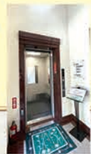
●エレベーター
